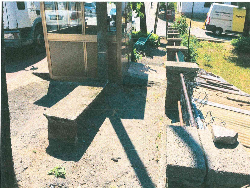
FOTO 6 Particolare della piazza di Cerignale con casetta in lamiera da sostituire
