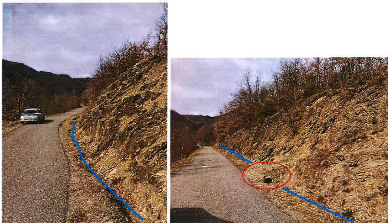
Figura 26 - Cunetta e passacunetta da ripulire
