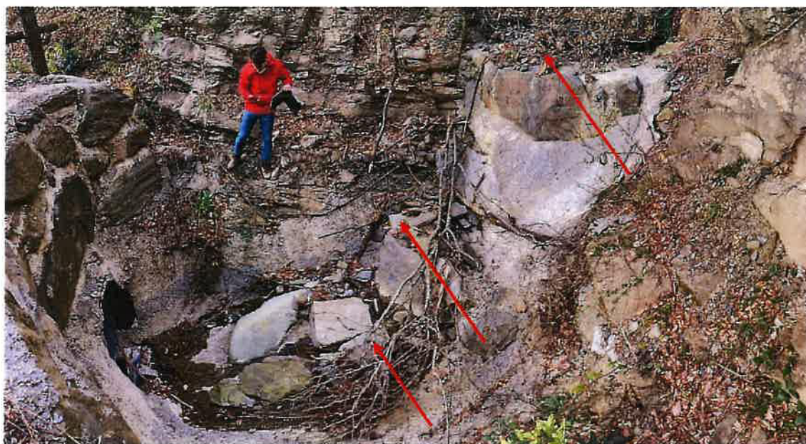
Figura 7 – Vasca di raccolta delle acque in prossimità dello scarico. In rosso sono evidenziati alcune delle criticità da eliminare
