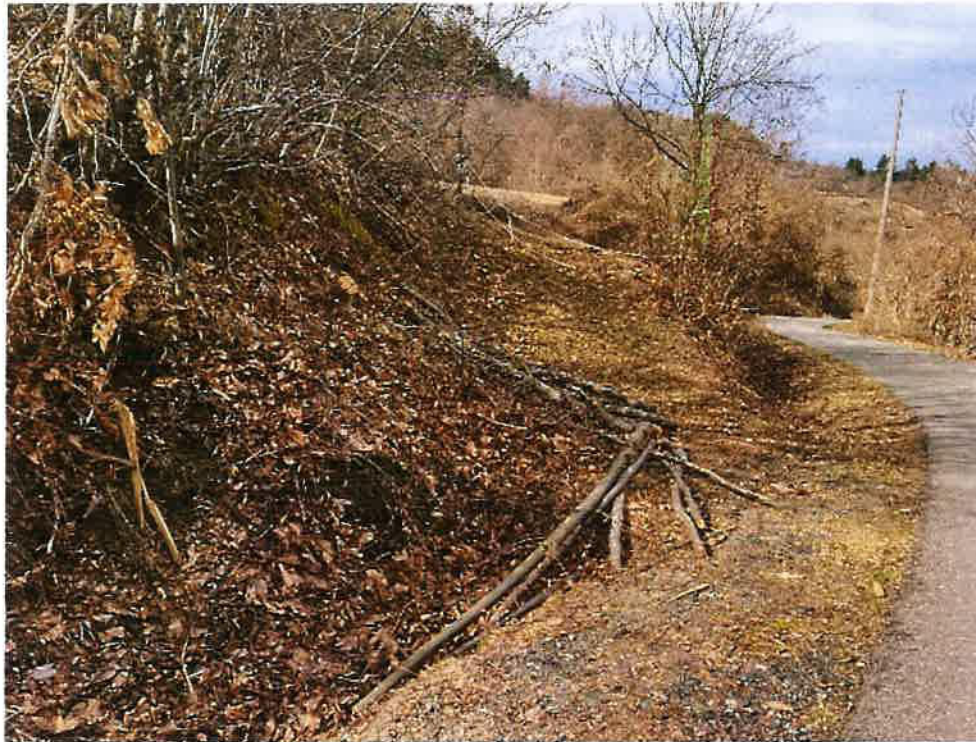
Figura 40 - Particolare del passacunetta da ripristinare
