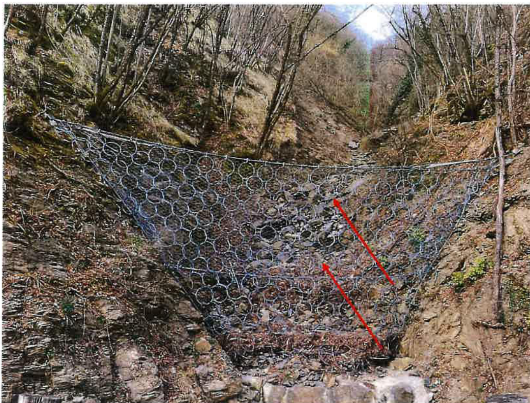
Figura 8 - Rete paramassi da ripulire dal detrito accumulato
