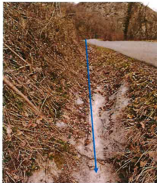
Figura 4 - Cunetta da ripristinare
