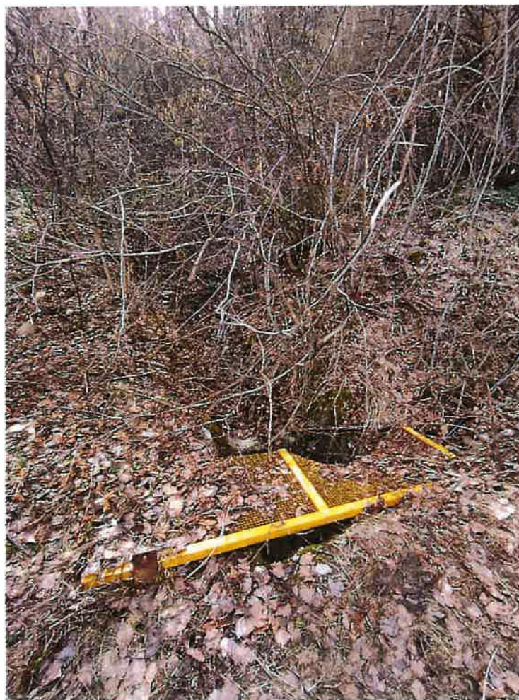
Figura 39 - Particolare della griglia da ristrutturare e del relativo tombino da ripulire
