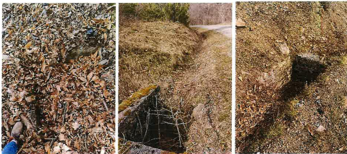
Figura 29 - Particolare dei tombini da ripristinare
