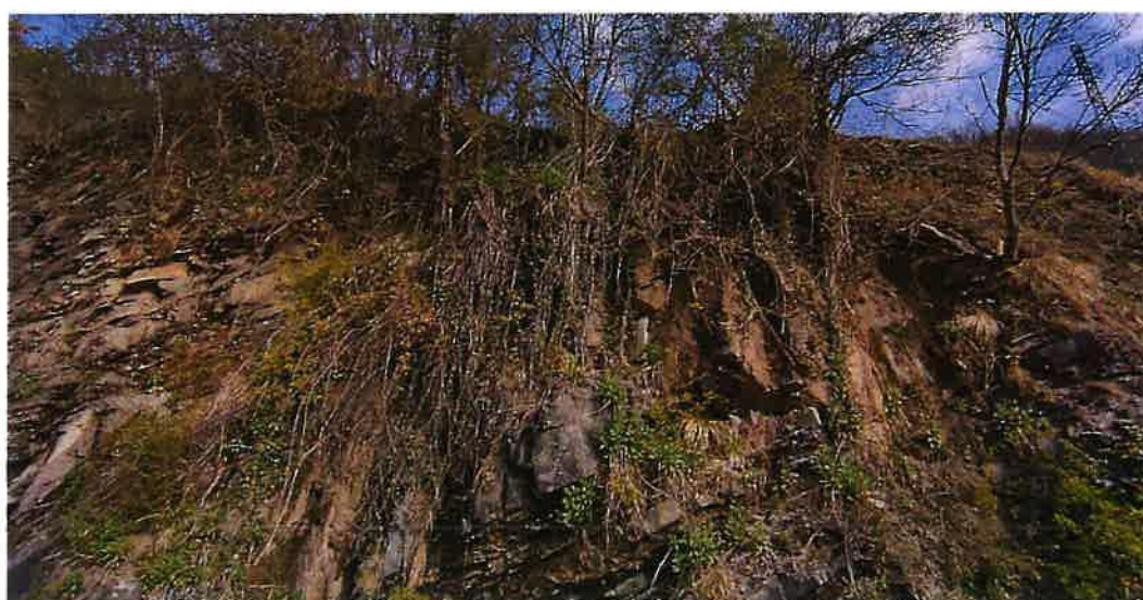
Figura 20 - Panoramica del tratto ove eseguire il disaggio e la posa della rete paramassi
