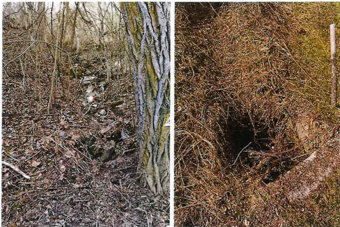
Figura 37 - Panoramica del fosso (a) e dettaglio di uno dei tombini (b) da ripulire
