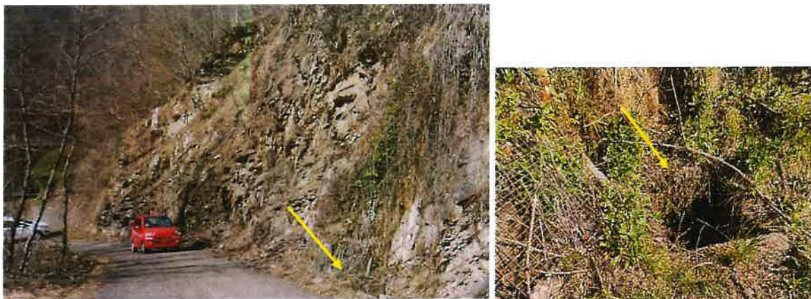
Figura 21 - Panoramica (a) e particolare (b) del tombino da ripulire
