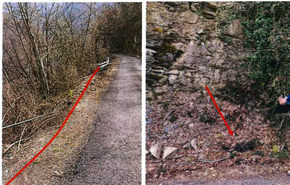
Figura 23 - Tratto di guard-rail da realizzare (a) e particolare del tombino da ripulire (b)
