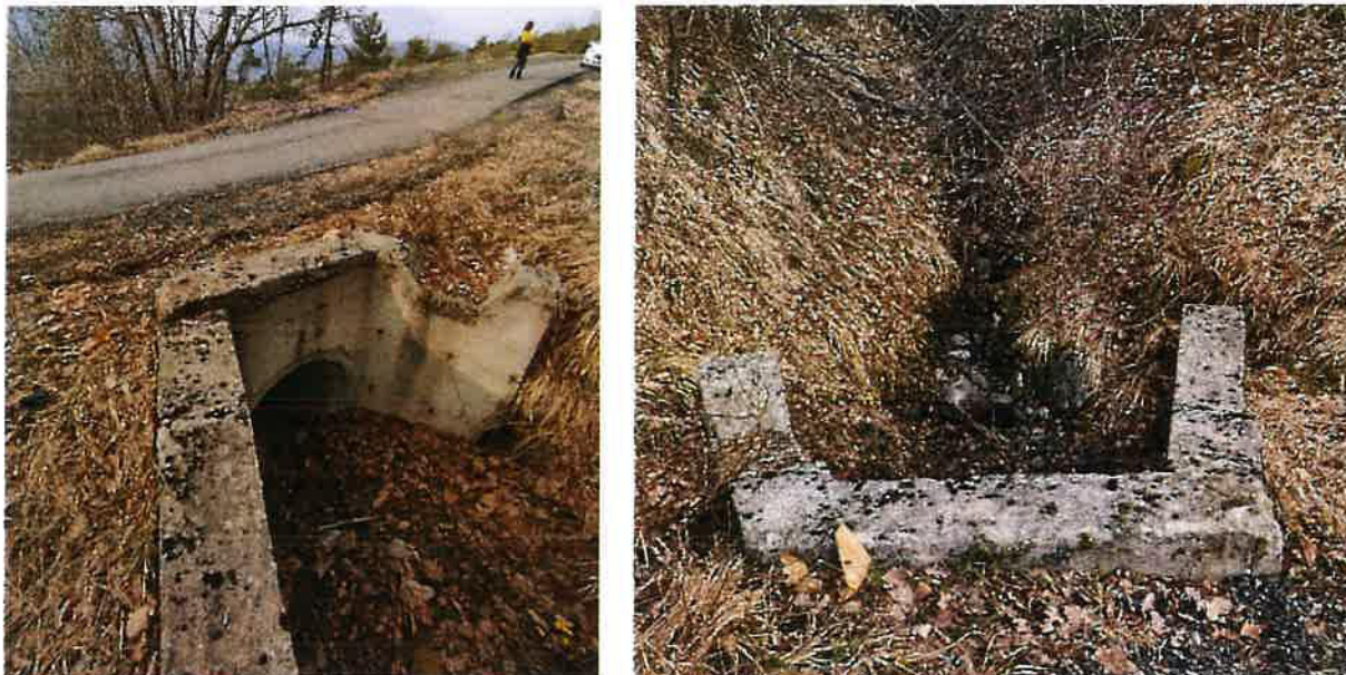
Figure 16-17 - Particolari visti rispettivamente da monte e da valle del tombino da ripulire
