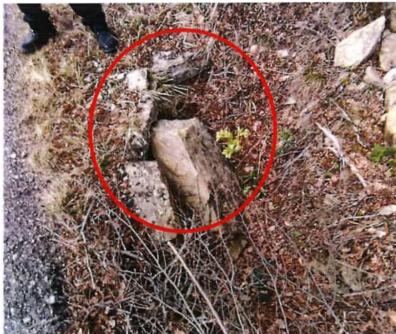
Figura 37 - Il pozzetto del tombino esistente risulta completamente distrutto, pertanto si rende necessaria la sua sostituzione.
