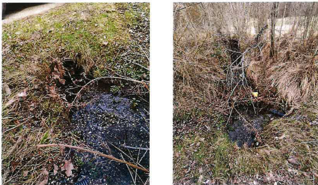
Figura 20 - sistema di scarico da ripulire in località Abrà
