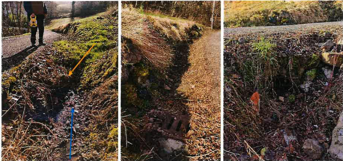
Figura 5 - Dettagli delle opere da realizzare: a) scarico esistente con cameretta da aggiungere (monte); b) tombino e relativo scarico da ripulire; c) scarico da ripulire (valle)
