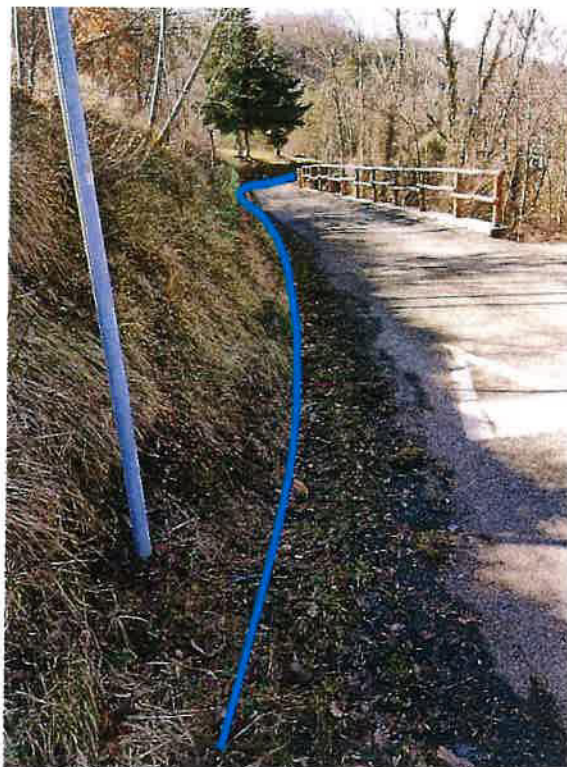
Figura 10 - Tratto di cunetta da ripristinare
