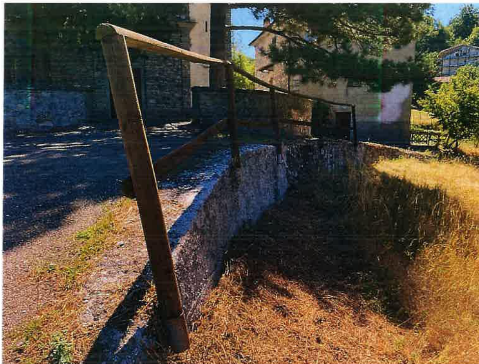
Figura 4 - Tratto B della staccionata da sostituire
